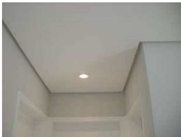
Figura 41: Exemplo de forro de gesso com pé solto.
