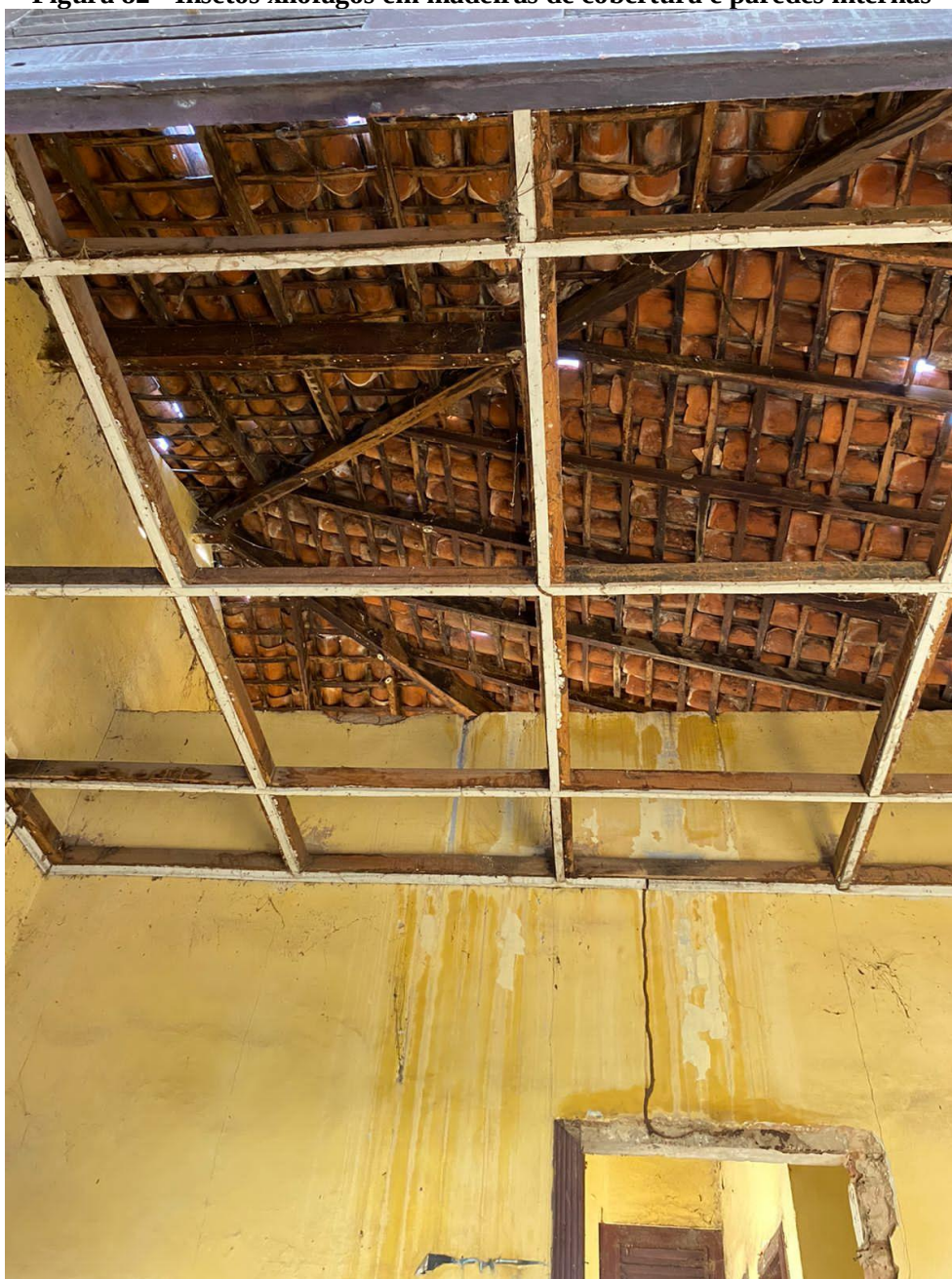
Figura 82 - Insetos xilófagos em madeiras de cobertura e paredes internas
