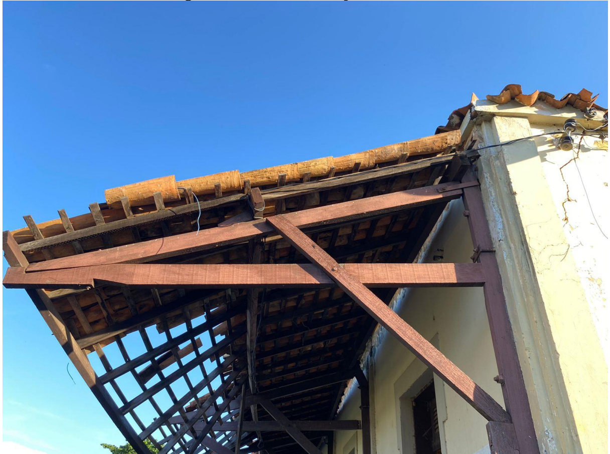
Figura 73 – Rachadura em parede externa
