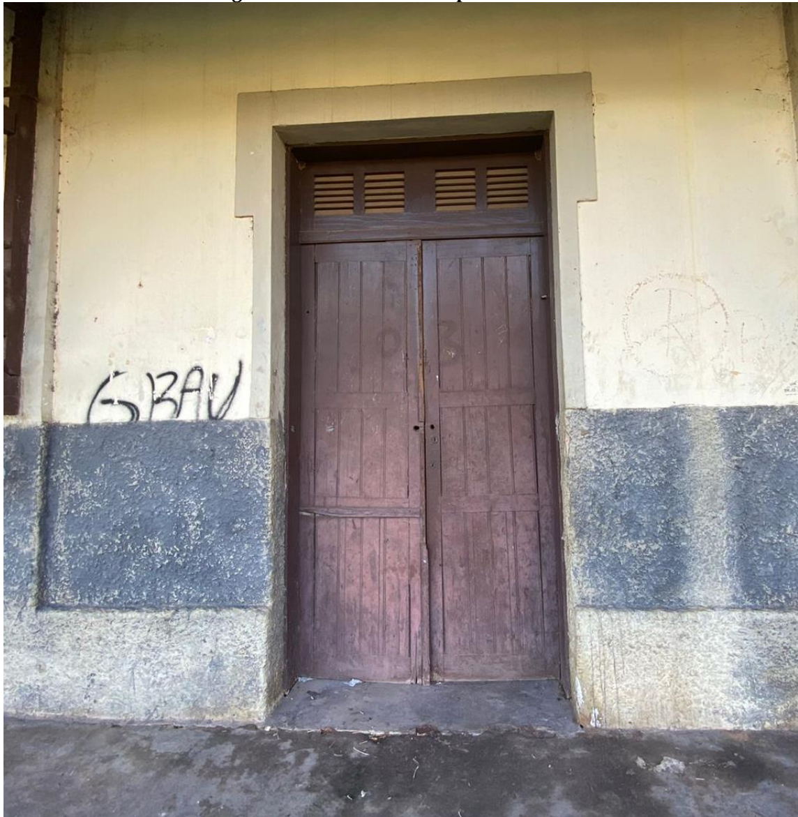
Figura 75 - Vandalismo em parede externa
