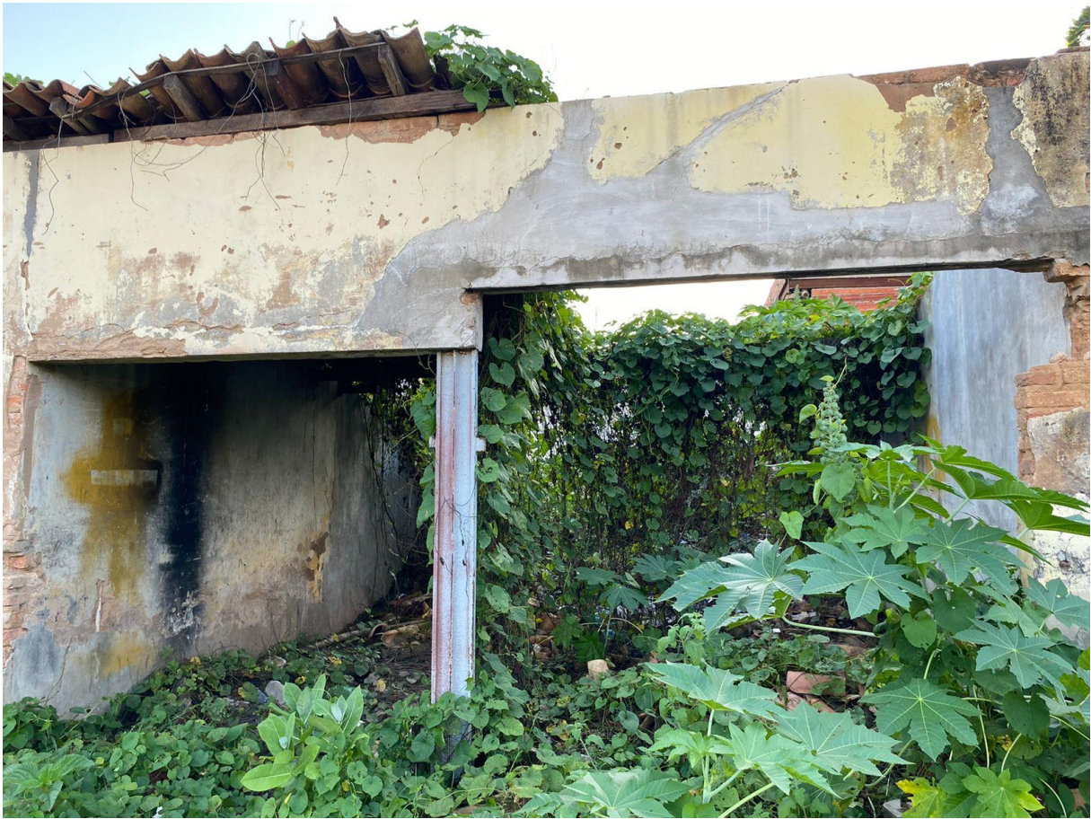
Figura 76 - Vegetação adentrando a edificação do Armazém
